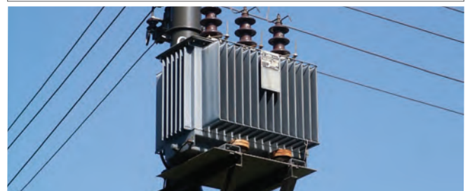
Die Transformatorüberwachung mit der Multilin DGCM Field RTU ermöglicht eine Überlasterkennung, was maßgeblich die Netzplanung und das Anlagenmanagement vereinfacht.
