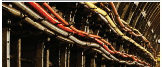
Der Einsatz der Multilin DGCM Field RTU für die Kabelüberwachung ermöglicht eine schnellere Fehlererkennung und -isolierung, wodurch Ausfälle sowie die Einsatzzeiten des Personals reduziert werden.
