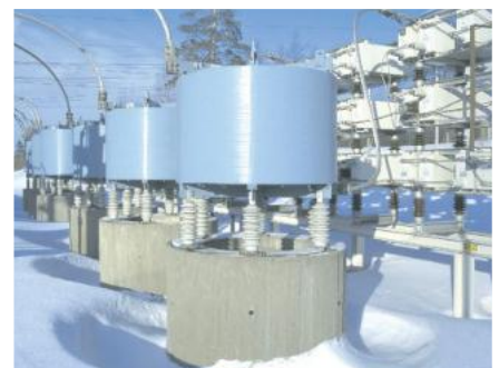
1.4 Filtro harmônico de AT (alta tensão)
