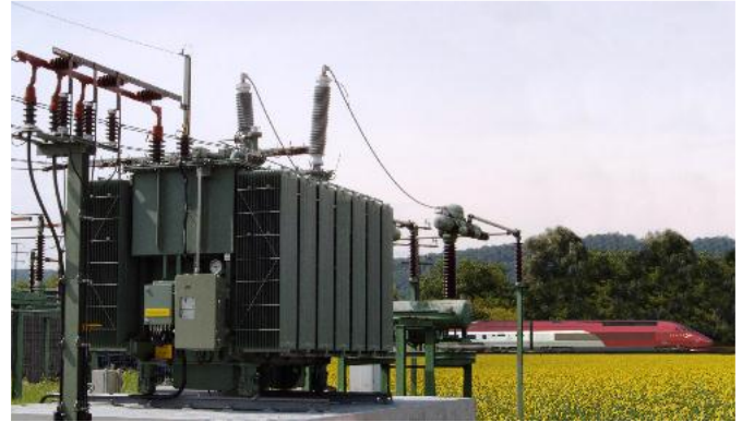
Transformador para trilhos de 15 MVA 120/17,25 kV 16,7 Hz
